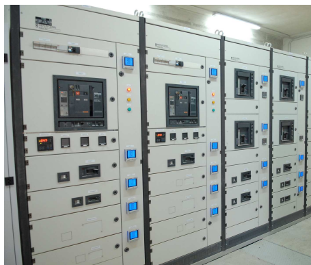
POWER CENTER – STOCCAGGIO CISA SpA
