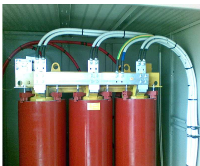
TRASFORMATORI EUROENERGY MODUGNO (BA)
