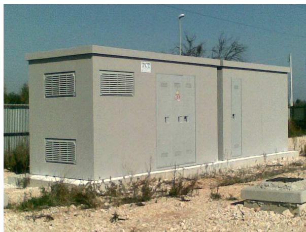
CABINA DI TRASFORMAZIONE MT/BT EUROENERGY MODUGNO (BA)
